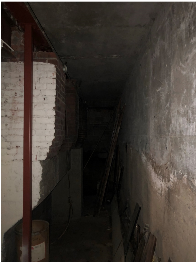
Photo OCH - B - 10: Chase under front steps.
