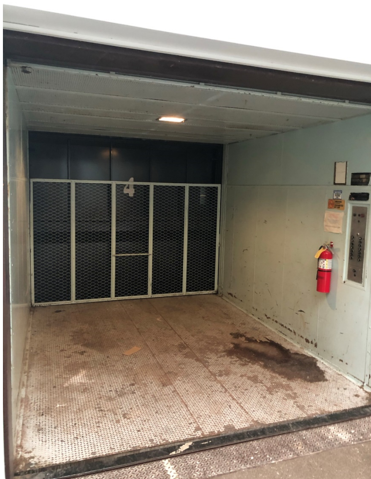
Photo OCH - 4 - 12: Interior of freight elevator.
